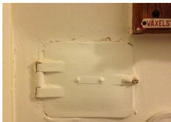
Befintlig lucka med huvudsäkring bakom
