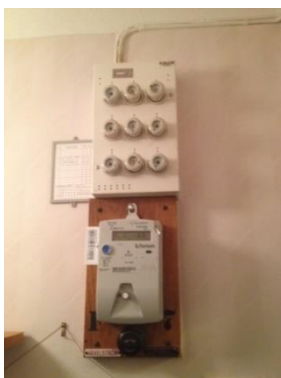
Befintlig mätartavla och elcentral
